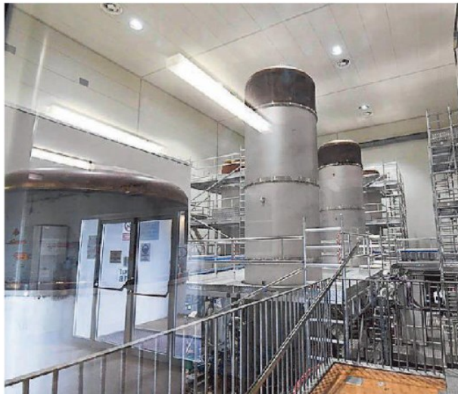
Alcuni degli impianti dell'osservatorio Virgo a Cascina
